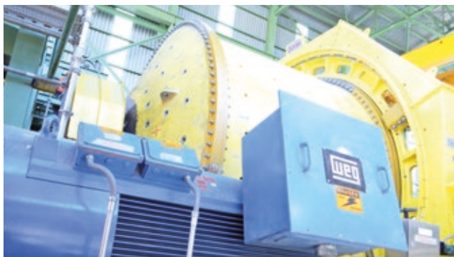
Potrerrillos Codelco Salvador - Chile Molinos de Bolas - Motor Jaula + VFD de media tension
