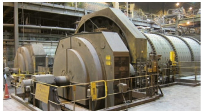
United Taconite LLC - Minesota EEUU Molino SAG de doble piñon - 2x motores sincronicos de baja velocidad + acople neumatico con sistema de distribucion de carga
