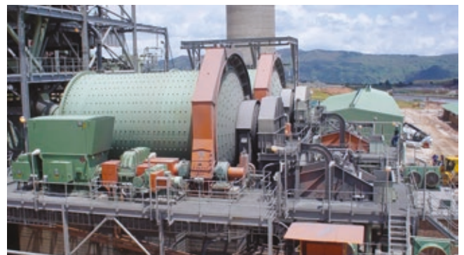
Everest South Platium Mine Molinos de Piñon Único: Motores de anillos rozantes con sistema de izaje de escobillas y reóstato líquido
